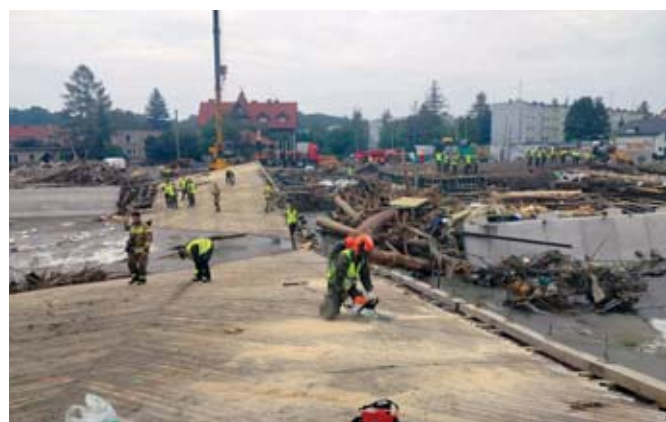
Rozbórka zalegających w korycie rzeki pozostałości po zniszczonych mostach – wycinanie drewnianego pokładu oraz demontaż zbrojenia mostu stałego – Głuchołazy
